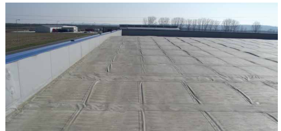
Építési hiba itt is...
