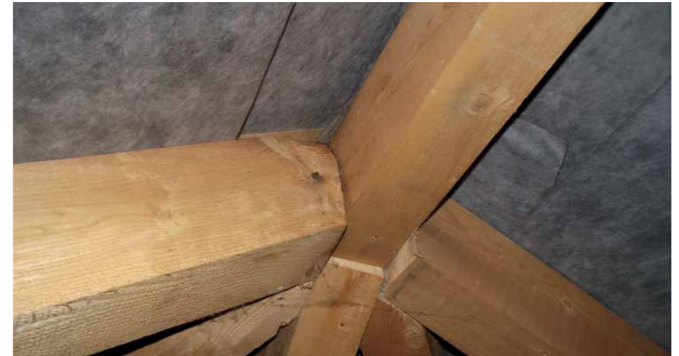
Építési hibák – igazságügyi szakértőként ezek nyomába ered
